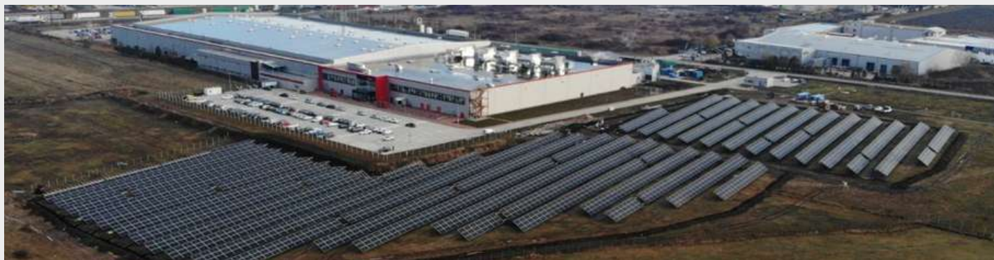
Structura din profile zincate pentru panouri fotovoltaice _ Montaj pe sol _ CEF Oradea
